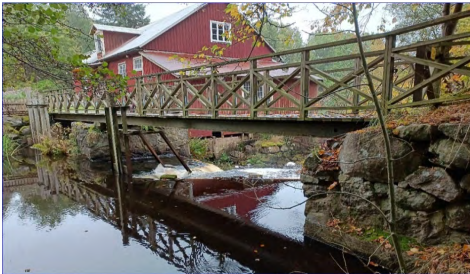
Figur 90: Fallet och regleringsluckor sett från norr.
