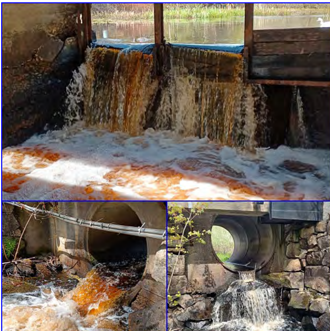
Figur 104: Vandringshinder nummer 11 består av en vägpassage kombinerad med dammvall där den mittre fåran (huvudfåran) leder upp till dammluckor (övre bilden) och de yttre sidofåran leder upp till vägtrummor (nedre bilder).
