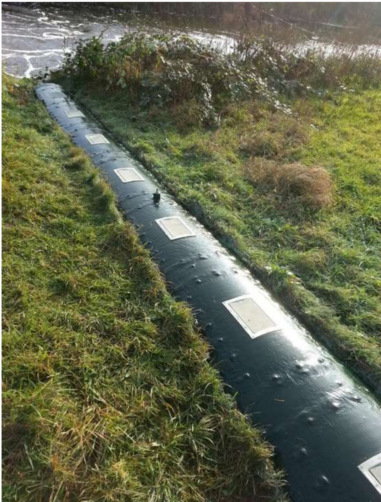
Figur 4 - Bild på anlagd och motfylld Siphon där enbart översta delen med inspektionsluckorna är synliga. (Fotografi från Fishflow innovations)
