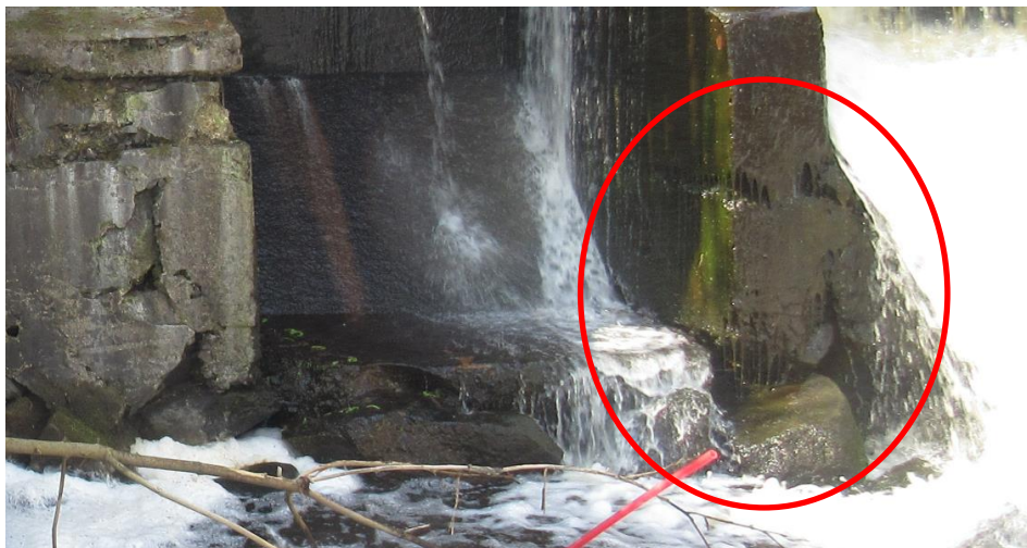
Figur 8 – Erosionsskada vid grundläggning av stödskena i anslutning till flodutskov. Foto WSP 2019
