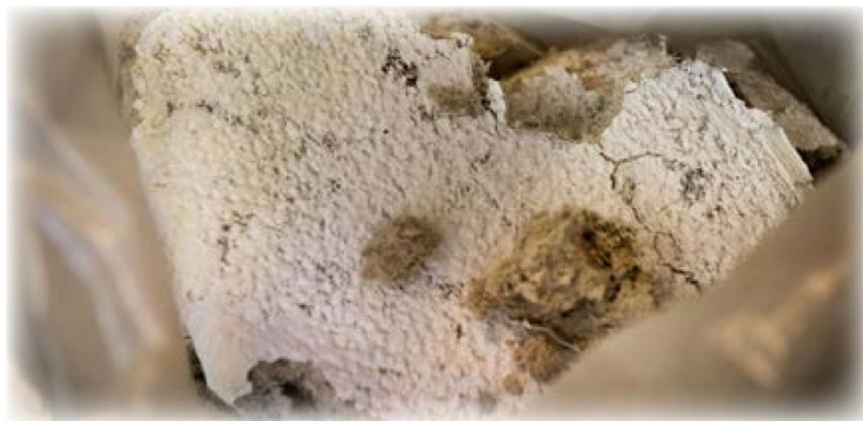
Asbest i isolering. Foto: Hans Alm, Arbetsmiljöverket
